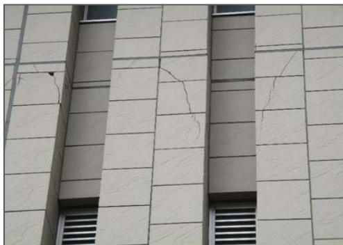
研究棟の外壁に亀裂
